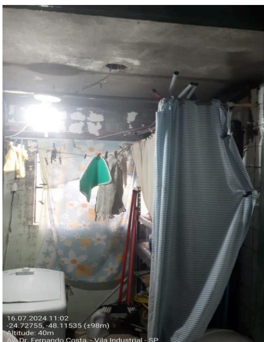
Área de serviço sem ventilação com umidade.
