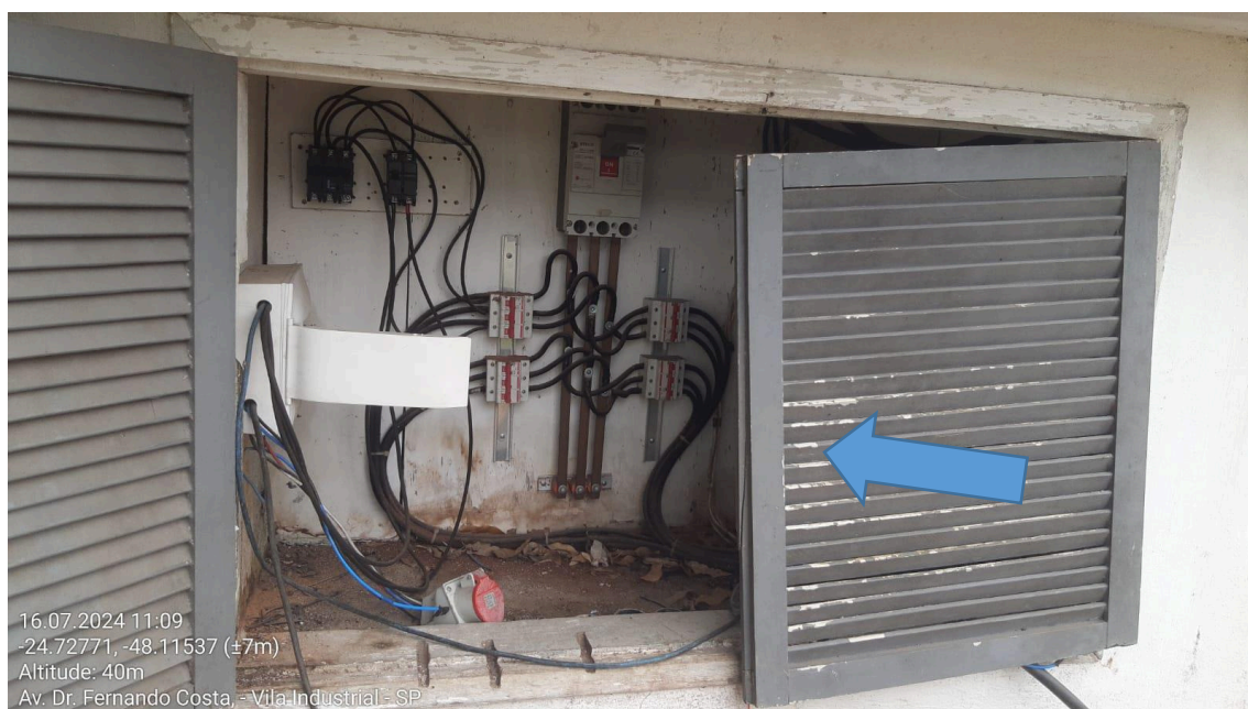
Padrão de energia sem padronização e proteção.
