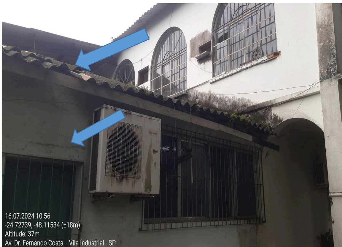
Telhas sobrepostas e trincas na parede.
