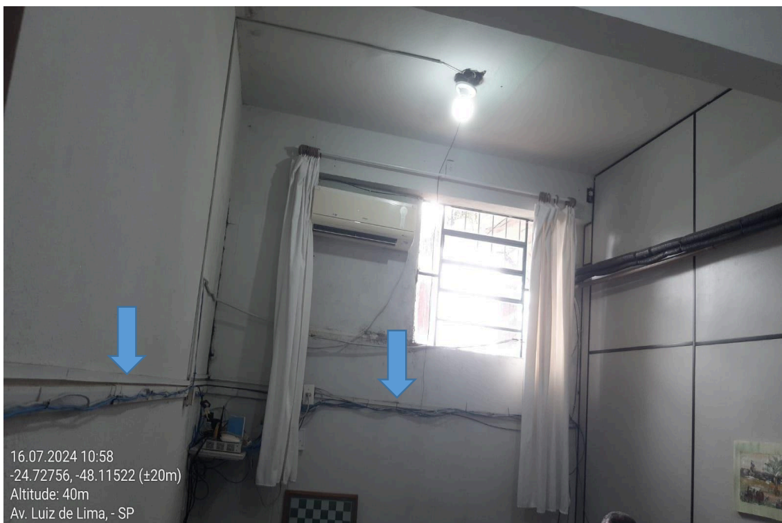
Cozinha com fiação elétrica aparente.
