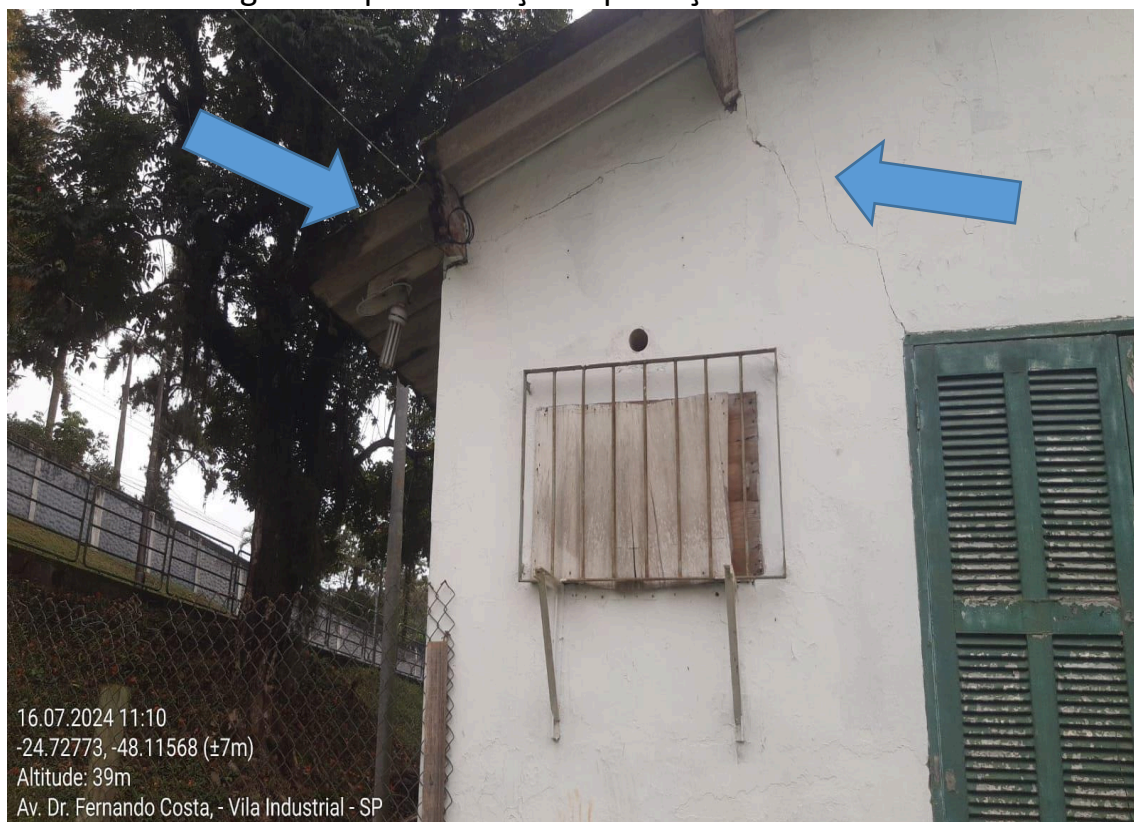
Cobertura quebrada e parede com trinca.
