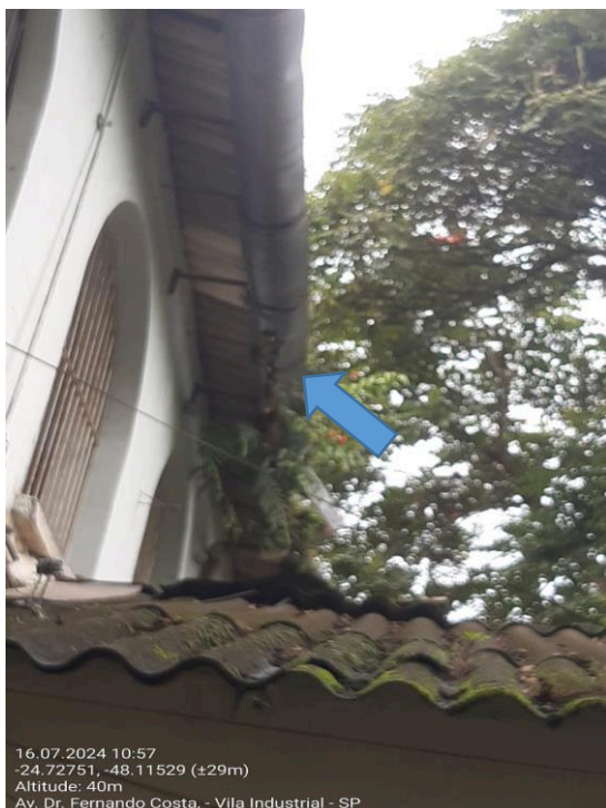
Cobertura e calha deteriorado.
