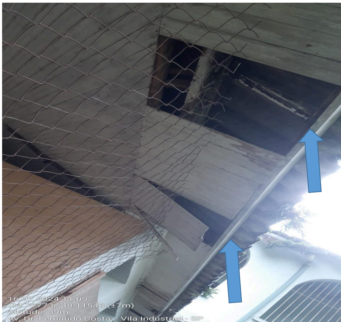
Estrutura do forro e da cobertura com cupim.
