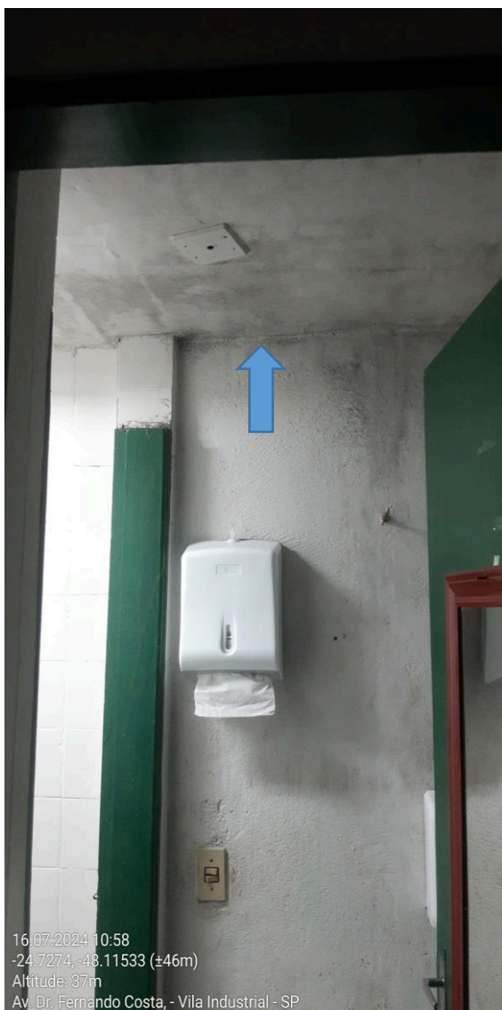
Umidade no sanitário.
