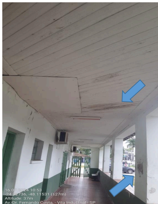
Corredor de acesso – forro com cupim e destacamento do reboco.
