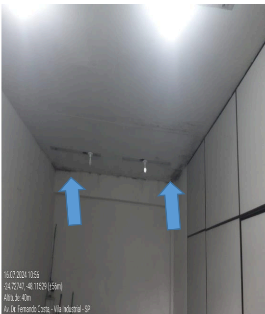
Sala com umidade no teto.
