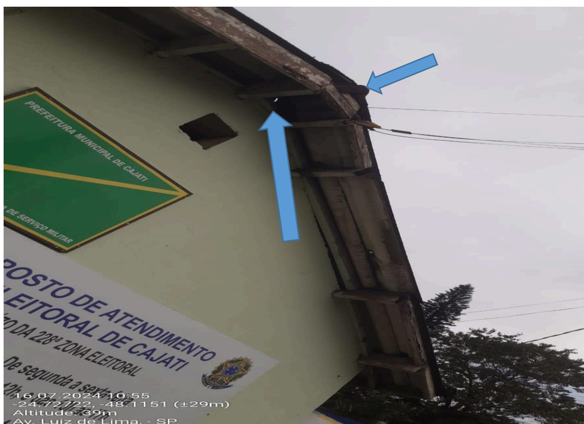
Cobertura e madeiramento em más condições.
