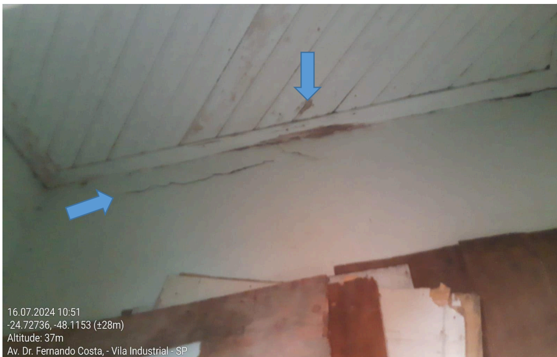
Forro com cupim e trincas na parede.
