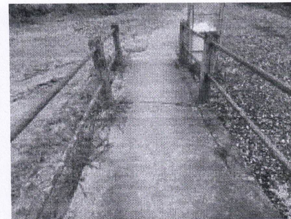
d) Pavimentação danificada.
