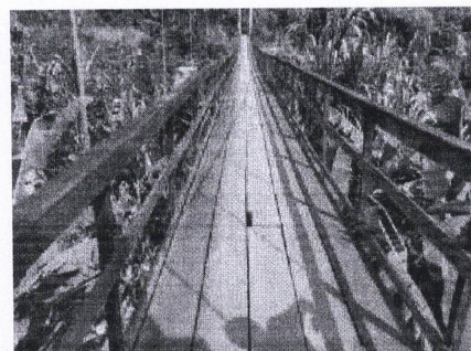
c) Assoalho danificado.
