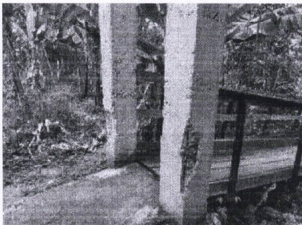
a) Pilarete danificado.
