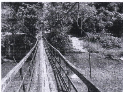
a) Assoalho conservado, estrutura danificada.
